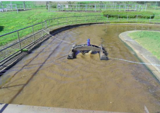
Oxidationsgraben Oxidation ditch
